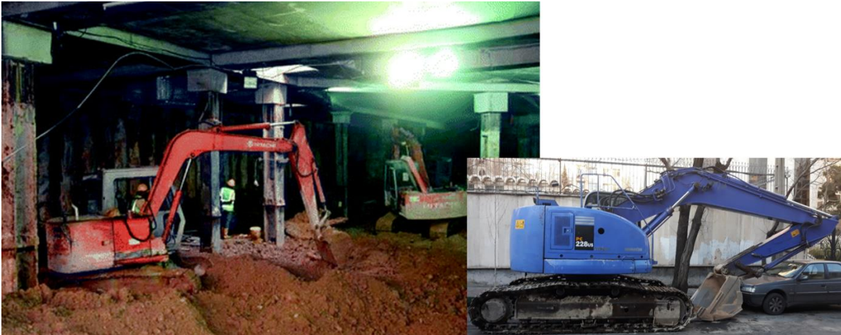
شکل ۷۰-۳ کندن خاک در زیر سقف طبقات زیرزمین و مابین ستون‌های سازه به وسیله بیل مکانیکی با اندازه متوسط در اجرای سازه به روش بالا-پایین
