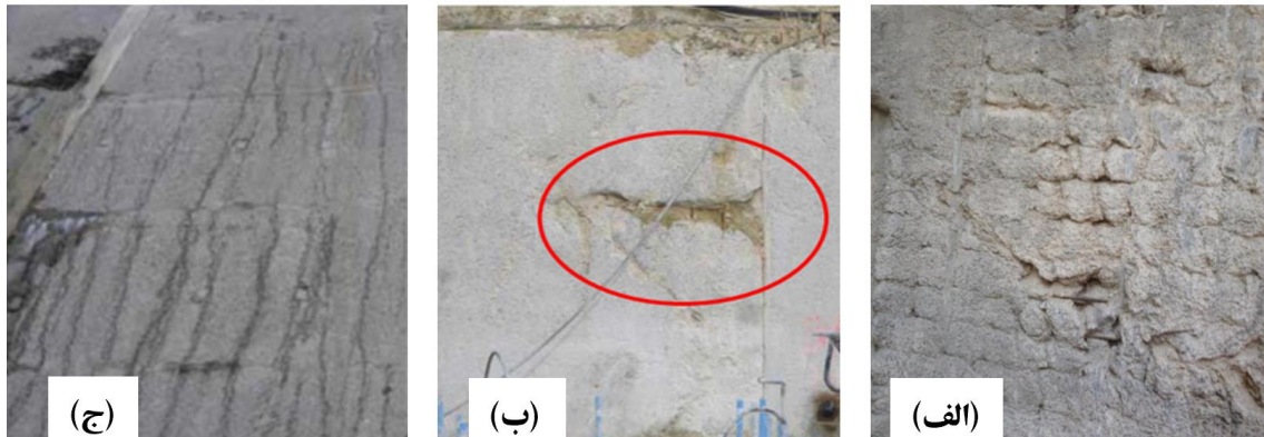
شکل ۳-۶۳ نمونه‌هایی از مسائلی که پس از نمایان شدن دیوار پدیدار می‌شوند؛ (الف) بیرون‌زدگی میلگردهای شبکه دیوار که نشان می‌دهد جریان افقی بتن در فضای خالی مابین میلگردها و خاک اطراف قابل توجه نبوده است، (ب) ایجاد حفره در دیوار به دلیل بیرون‌زدگی خاک یا سنگ به داخل ترانشه و تداخل با بتن‌ریزی دیوار، (ج) آب انداختن بتن دیوار و ایجاد رگه‌های قائم از آب انداختن
