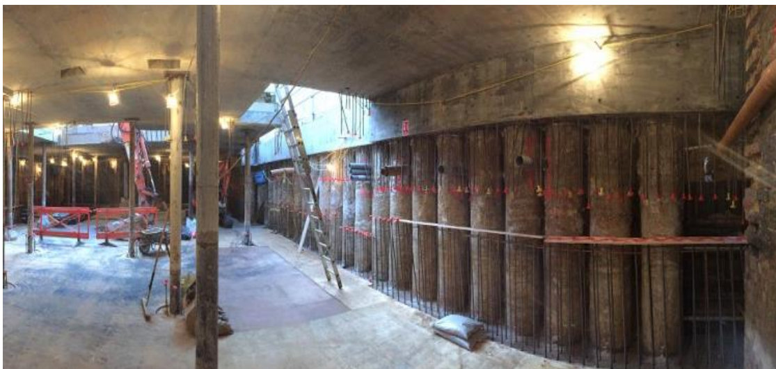
شکل ۳-۵۲ استفاده از دیوار شمع‌های متصل به عنوان دیوار حائل مدفون در اجرای سازه زیرزمینی به روش بالا-پایین (پس از خاکبرداری و هنگام تکمیل سازه زیرزمینی در هر طبقه، دیوار حائل بتنی دائمی سازه بر روی دیوار شمعی به صورت از بالا-پایین اجرا شده است).
