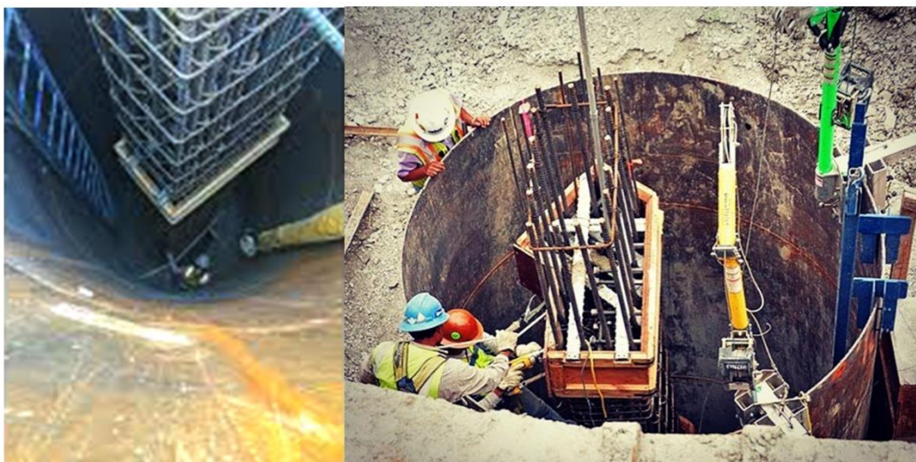
شکل ۳-۳۸ آرماتوربندی و قالب‌بندی ستون بتنی در یک چاه پایدار شده با غلاف فولادی، راه دسترسی ایمن، تهویه و روشنایی برای نیروهای کار تامین شده است
